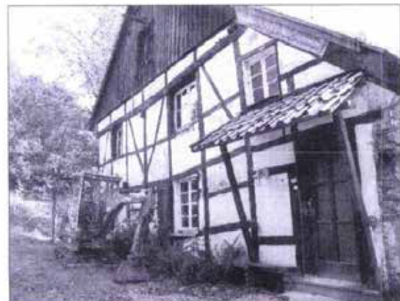
Das windschiefe Gebäude des alten Abshofs soll im nächsten Jahr saniert werden.
